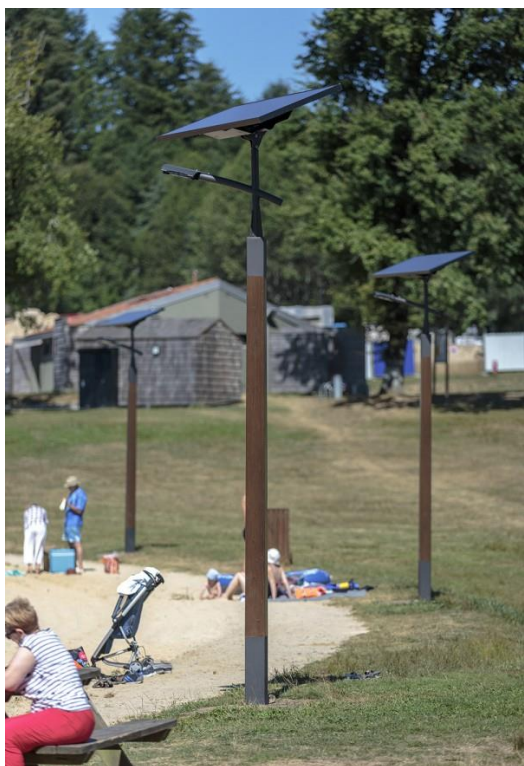
Solariser les équipements qui le peuvent
